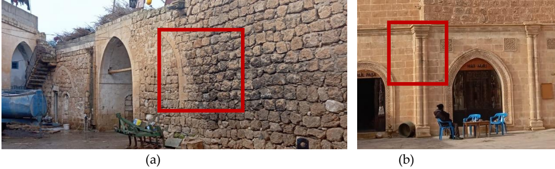
Şekil 21: (a) Hayvan Hanı avlu duvarında siyah tabaka oluşumu, (b) Estel Hanı (avluya bakan cephe siyah tabaka oluşumu) (2023)
